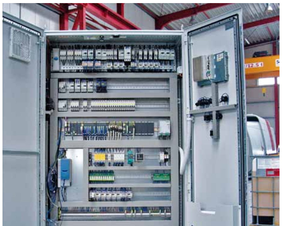
▲ Steuerschrank in der Gondel
